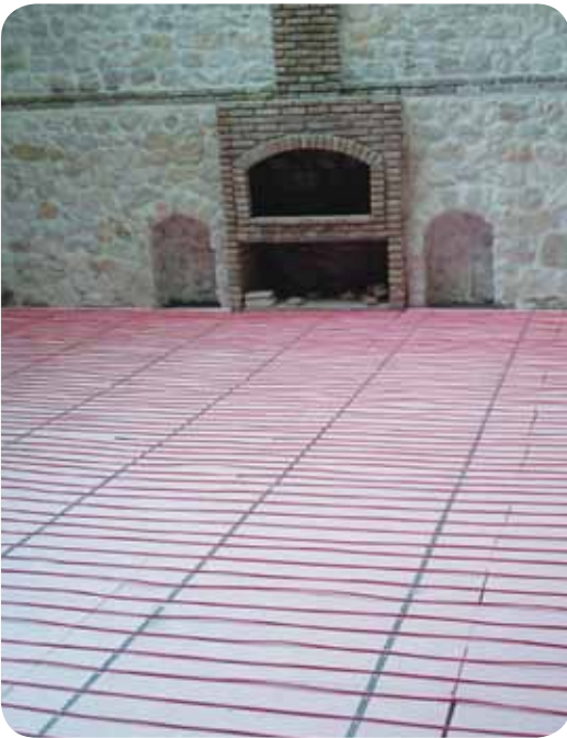
Antakya Otel Lobisi - Elektrikli Döşemeden Isıtma HATAY
