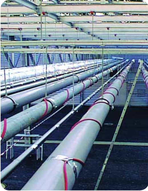
Ford Kamyon Fabrikası - Boru Isıtması Sistemi ESKİŞEHİR
